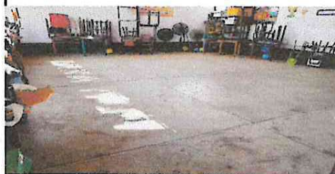
Foto 2: piso en mal estado, gretado. Del modulo 7
