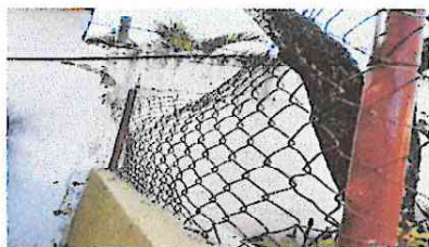
Foto 1: malla del muro de entrada dañada, 15 mt2
