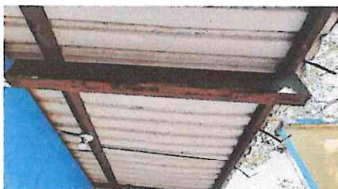
Foto 3: Costaneras en mal estado por el óxido
